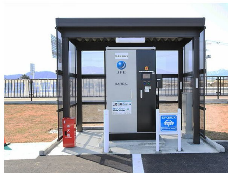
電気自動車用充電設備 出典：道の駅米沢 HP
