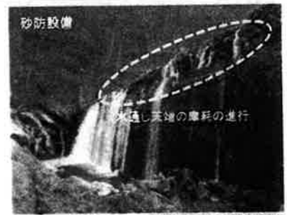
砂防堰堤の天端摩耗による堰堤の土砂捕捉機能低下
