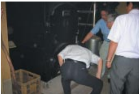
薪ボイラー（いの町）
