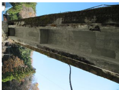
図 1.3 コンクリート橋の損傷状況
