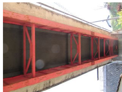
図 1.4 鋼橋の損傷状況
