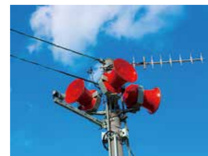
防災行政無線システム（同報系）整備事業
