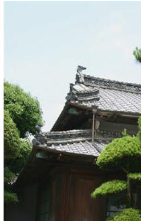
■老朽化により屋根根部からの雨漏りがみられる
