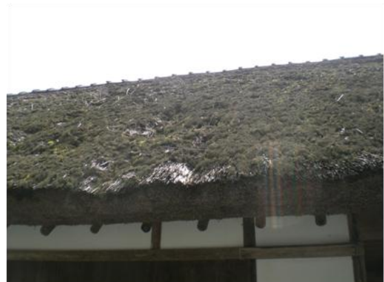
■平成5年に葺き替えされたが、現在では老朽化で屋根部の傷みがひどい
