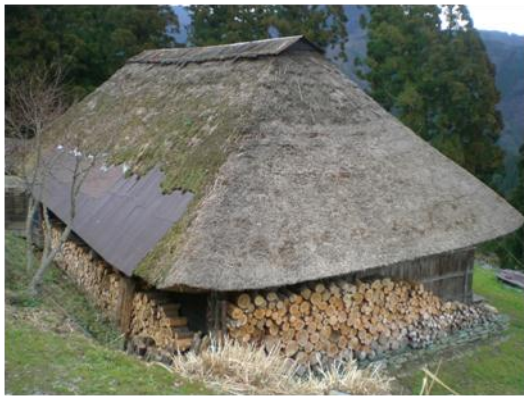
■ 屋根の葺き替えが急がれている
