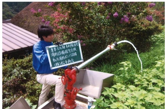
重要文化財木村家住宅での防災設備の保守点検 (実施日:H24. 9. 2)
