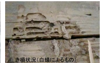
き損状況(白蟻によるもの)
