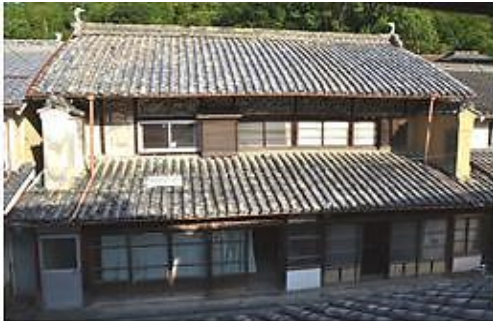
■整備予定の山下家別邸 伝統的な町並みの中心部にある明治期築の町屋で、辻の町並みの歴史を知る上で貴重な歴史的建造物となっている。
