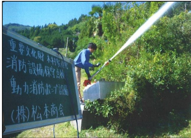
重要文化財木村家住宅での防災設備の保守点検 (実施日:H26. 10. 16)
