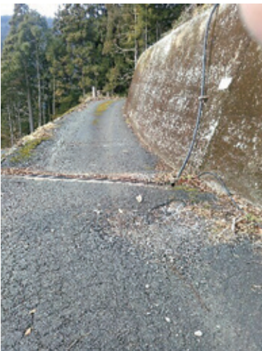
舗装が悪い市道。
